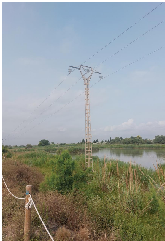
Línea de media tensión con postes que atraviesa actualmente la marjal
